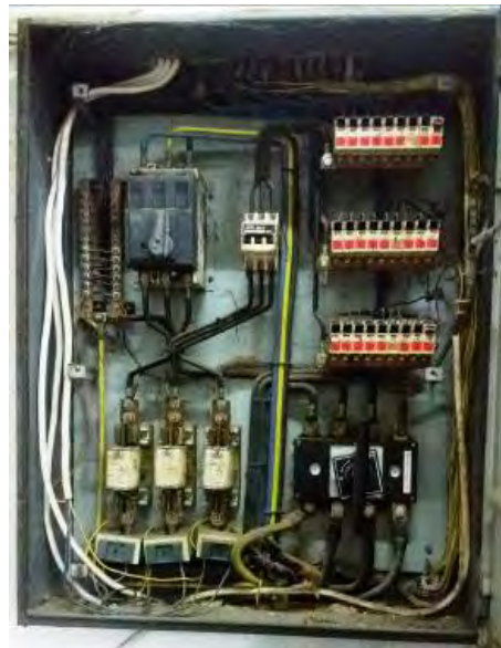
Gambar 11. Tampak dalam panel utama di bengkel listrik
