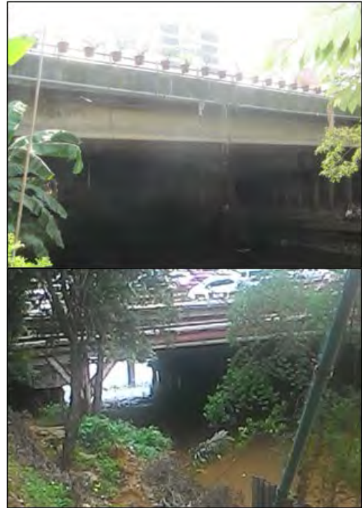
Gambar 7. Foto Jembatan MT. Haryono kondisi aliran normal dan bekas batas MAB pada lantai jembatan
