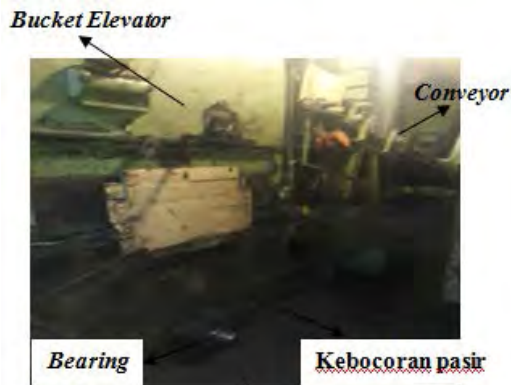
Gambar 1. Bucket elevator kondisi terpasang
