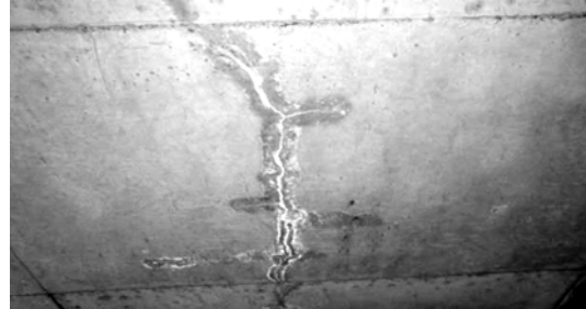
Gambar 3. Rembesan pada beton yang retak
