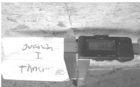
Gambar 6. Pengukuran lebar retak
