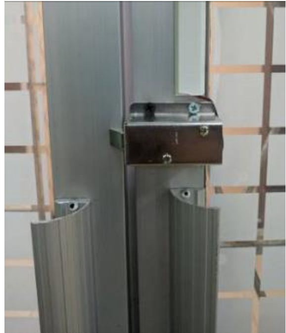
Gambar 11 Implementasi Pemasangan Solenoid Door Lock
