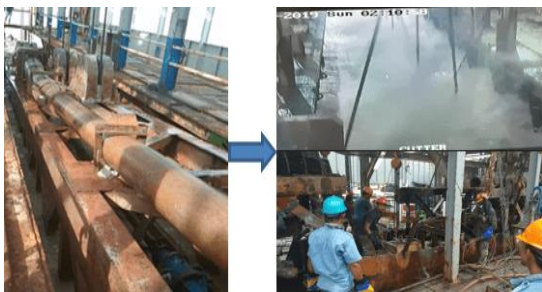
Gambar 10. Konstruksi ladder KIP yang mengalami gagal struktur pada brace pondasi katrol [5].
