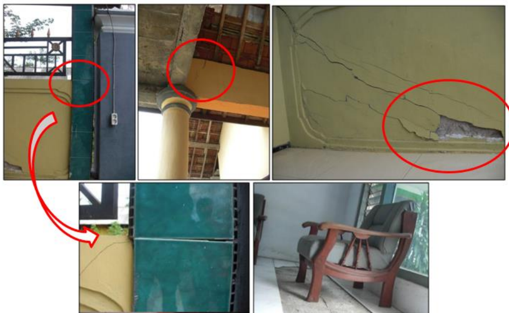
Gambar 3. Dokumentasi kerusakan rumah warga
