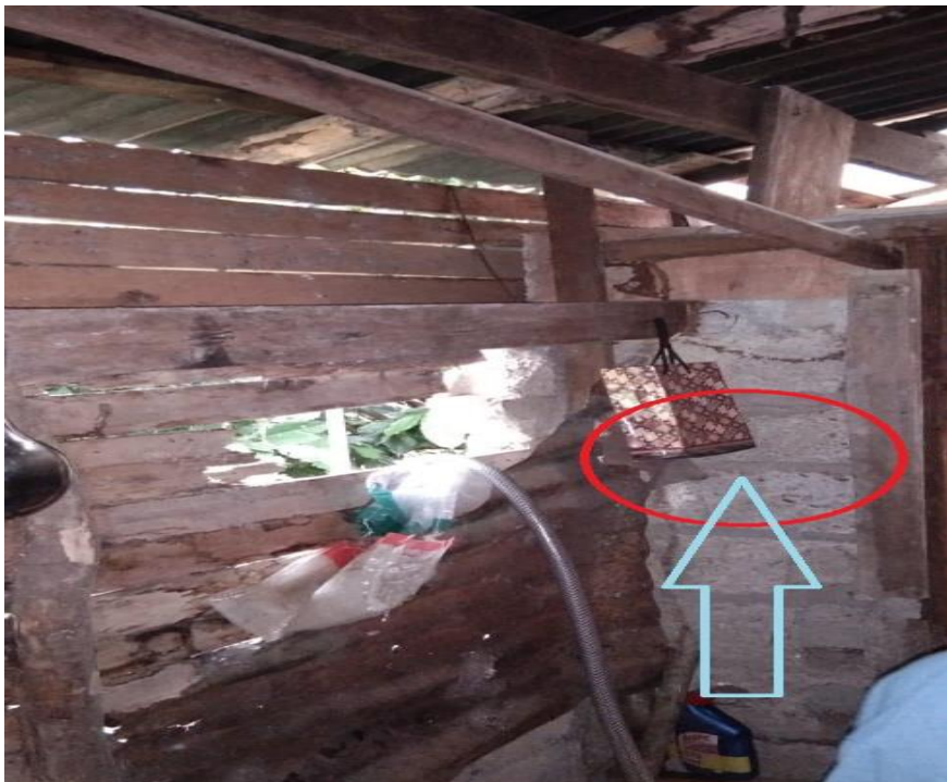
Gambar 8. Kerusakan dinding dapur tanpa balok pinggang.
