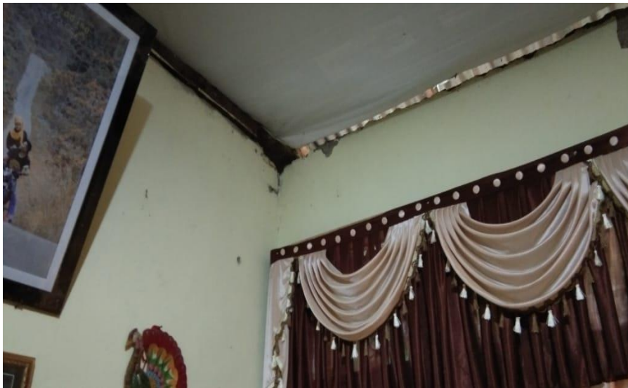
Gambar 9. Dinding yang tidak menyatu dengan kuda-kuda rumah.
