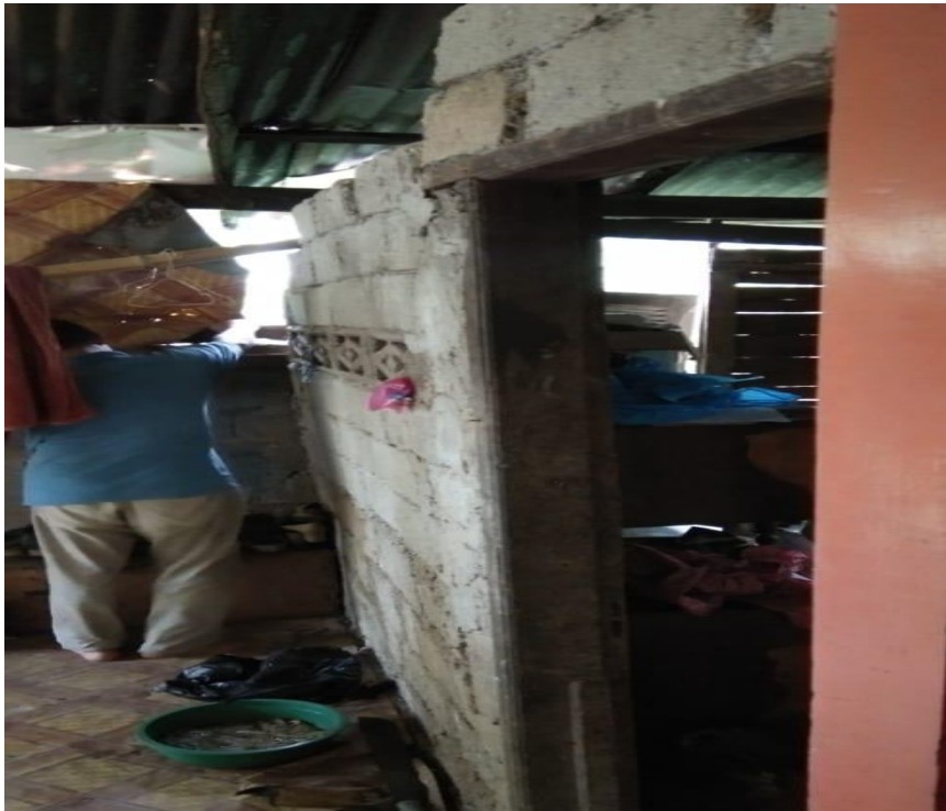
Gambar 7. Kerusakan struktur utama akibat tidak menggunakan sloof.
