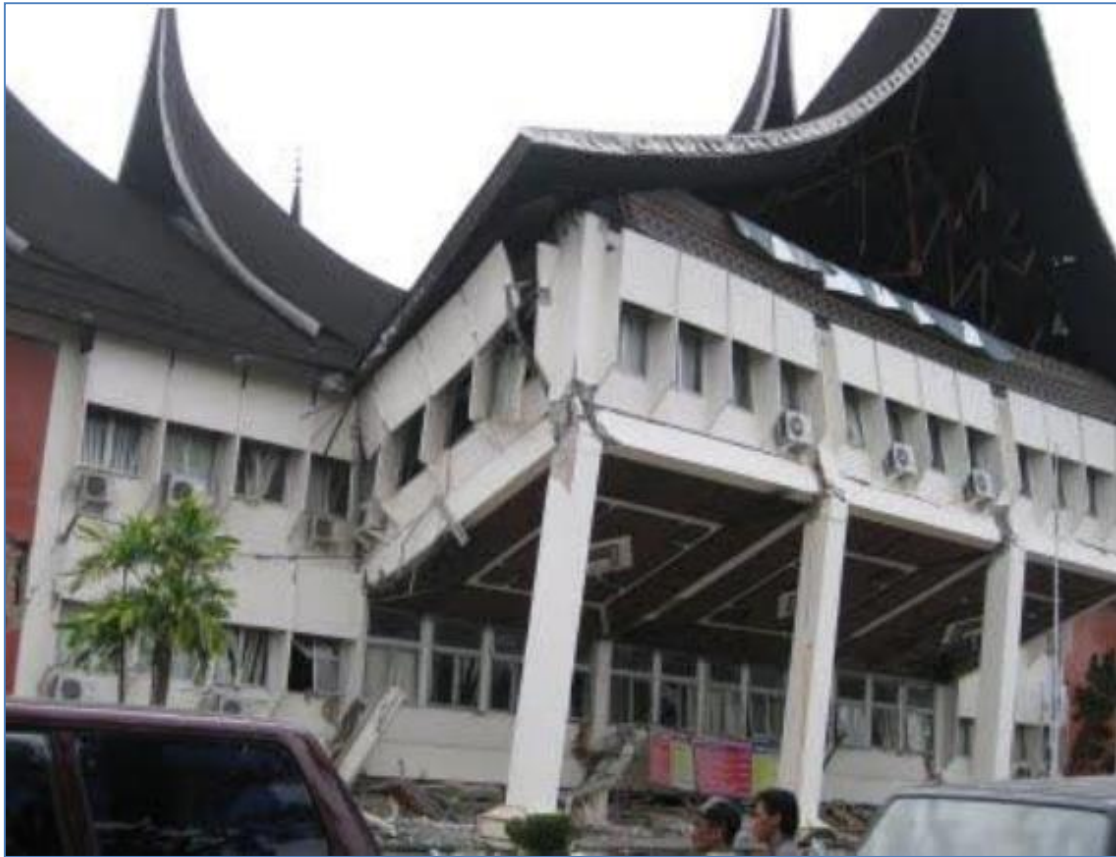
Gambar 1. Keruntuhan bangunan publik akibat gempa 2009 [2].
