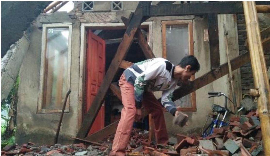
Gambar 2. Kerusakan bangunan rumah warga akibat gempa [6].
