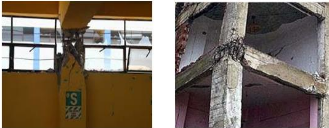
Gambar 1. Kerusakan akibat gempa [1].
