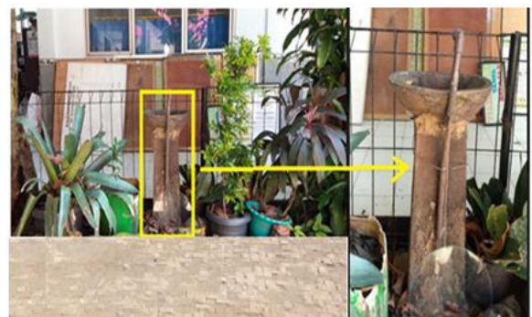
Gambar 1. Kondisi wastafel SDN Kukusan yang rusak
