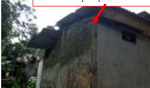
Gambar 2. Kondisi atap eksisting
