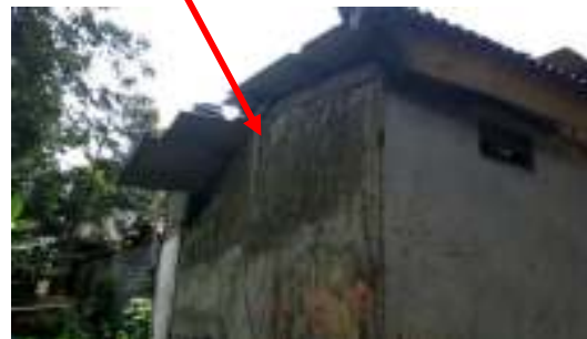
Gambar 6. Dinding eksisting yang roboh
