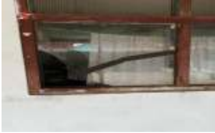
Gambar 4.7. Kondisi Kaca Ruang Kelas.
