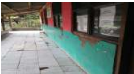
Gambar 3.3 Kondisi Dinding kelas.
