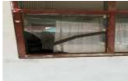
Gambar 5. Kondisi Kaca Ruang Kelas.
