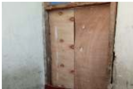
Gambar 4.9 Kondisi Pintu Toilet
