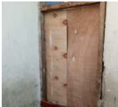
Gambar 3.6 Kondisi Pintu Toilet
