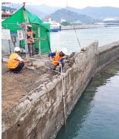
Gambar 7. Pemasangan Sensor Water level
